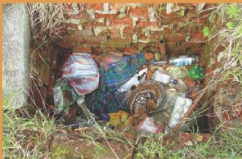
Několik dní staré srnče spadlo do nepoužívané odkryté šachty na vodoměr Nezakryté studny, jámy, bazény jsou nebezpečné nejen pro zvířata
